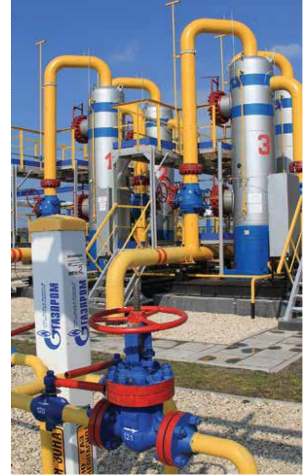
Газораспределительная станция №22 в Ульяновской области
